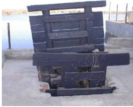
Figura 9 - Comporta que permite a entrada de Água vinda do mar para o Tejo
