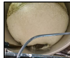
Fig. AIII.9 – Tanques de pré-aquecimento para clarificação e floculação das impurezas
