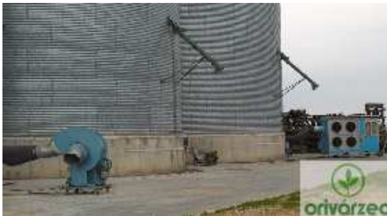
fig. 29 – Aspecto dos ventiladores móveis (esquerda) e de máquina de ar frio (direita). (Fonte: Orivárzea S.A.) .
